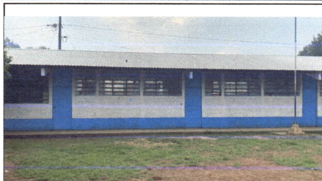
Foto 2: Se sustituirán las ventanas deterioradas por balcones de metal para mejorar la ventilacion e iluminacion dentro del aula.
