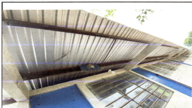
Foto 1: Se removerá el oxido en las costaneras de metal para pintadas y darles un aspecto nuevo y asi mejorar el ambiente dentro del aula.
